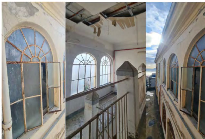
Infissi con struttura in ferro arrugginito
